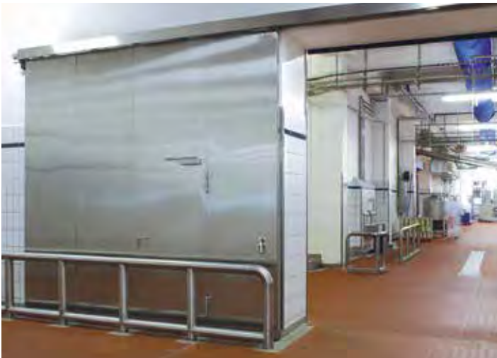
T30 Feuerschutz-Schiebetor, mit Schlupftür, in der Lebensmittelproduktion.
