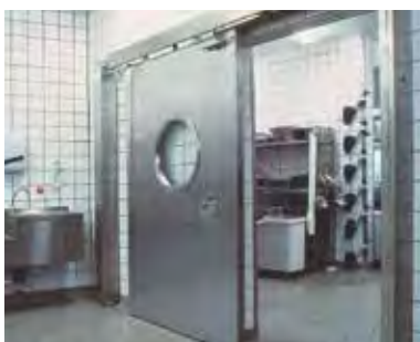
Feuerschutz-Schiebetor in einer Großküche.
